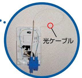
光コンセント (既存の電話モジュラーjack位置に取り付け、光ケーブルを白いケース内に収納後、蓋をします。)
